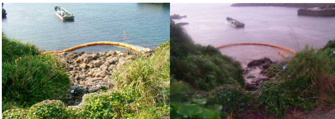
写真3. 海洋の汚濁防止膜の設置状況（右の写真は降雨時の模様） 切り土のり面からの降雨による泥水流入防止を行いました
