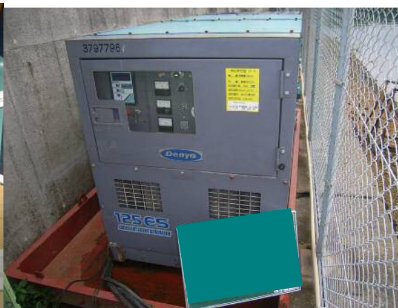
写真 11．燃料油漏洩対策として発電機の下にパレットを設置
