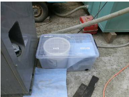
写真3. 給油口付近にはオイルマットを常備しています。
