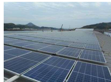
太陽光パネルの設置状況
